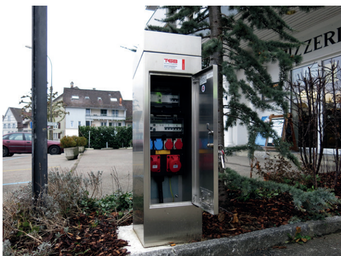
Colonnina d'energia elettrica QUADRO
